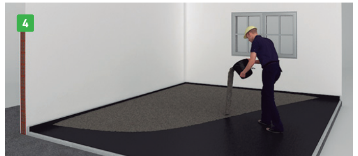
Colocar una malla de acero electrosoldada sobre el film con separadores. Volcar el contrapiso y realizar la carpeta.
